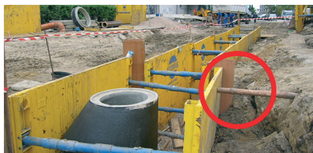
Rys. 7. Obudowy tymczasowe należy opuszczać do wykopu metodą „Tnij i obniżaj”, dzięki temu zabezpieczamy infrastrukturę towarzyszącą przed osiadaniem, osuwaniem. W pokazanym przypadku wykonawca doprowadził do rozluźnienia gruntu za obudową. Wykop powinien być obsypany
